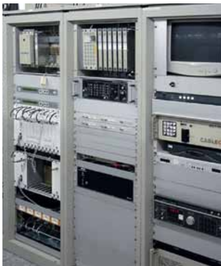
Die Kopfstation in Zuchwil ist das technische Herzstück. Die Bilder zeigen die Anlage früher...
